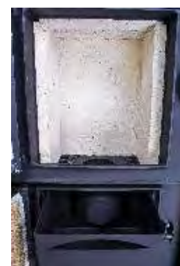
Camera di combustione in refrattario
