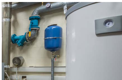
Sostegno di vasi d'espansione
