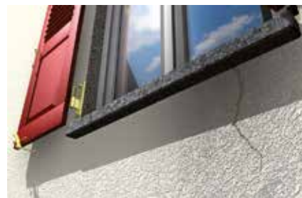
Fessure sulla parete
